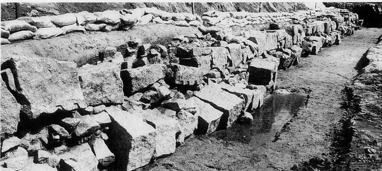
c. N36区以東の石垣列崩落状況
